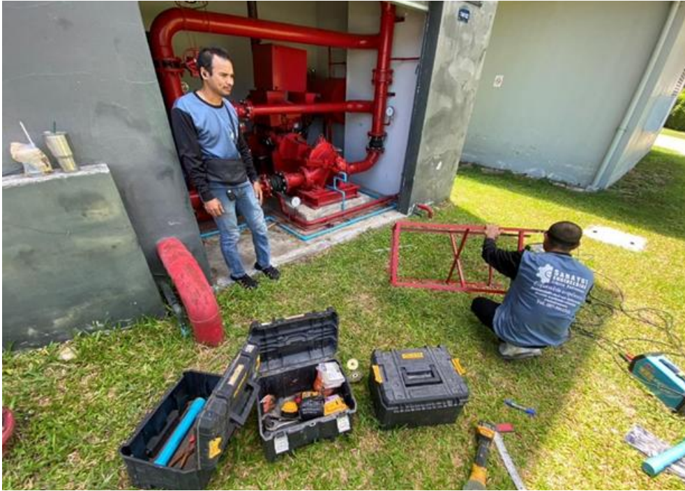
ตรวจสอบ บำรุงรักษา และซ่อมแซมระบบเครื่องสูบน้ำดับเพลิง
